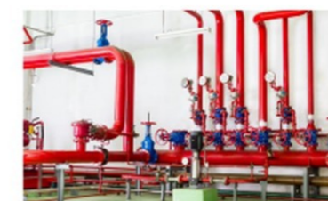
Ứng dụng trong phòng cháy chữa cháy Application of fire protection
